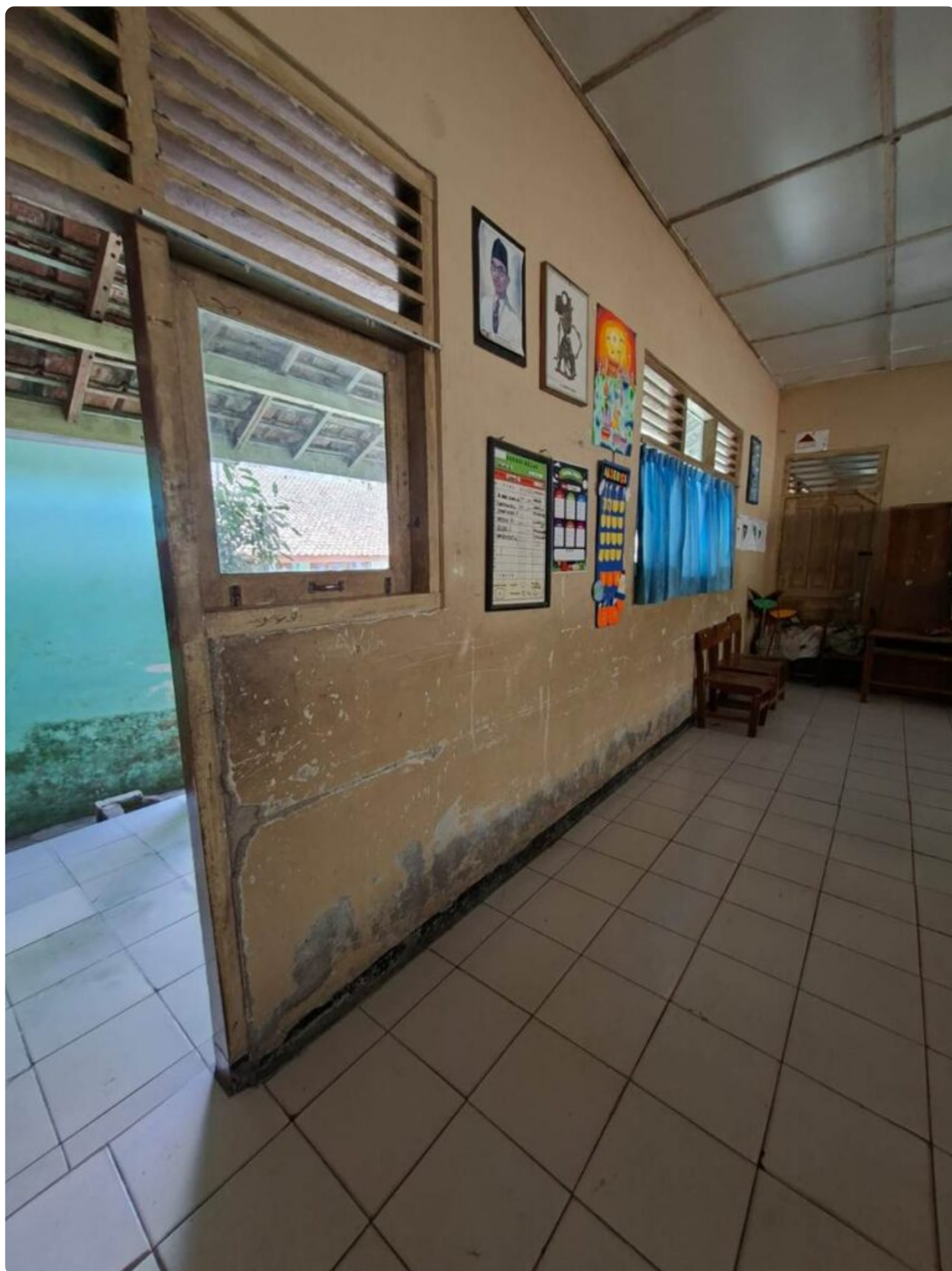
Gambar 7. Lantai koridor yang rusak.
